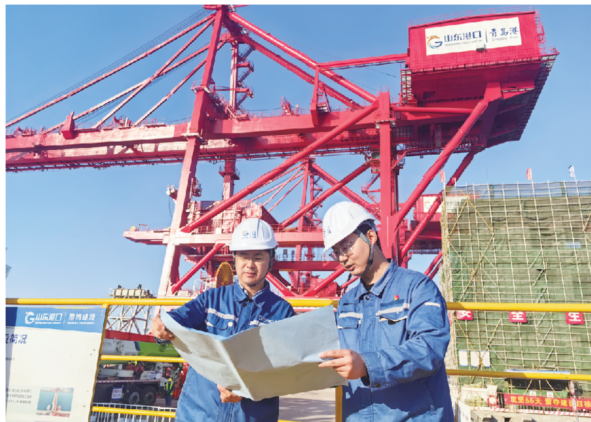
在山东港口青岛港董家口第二座40万吨级矿石码头建设现场,项目人员正在推进码头建设。
